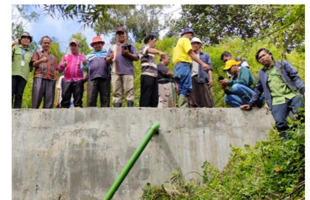
Toba Pulp Lestari hadir berkontribusi dalam pembangunan instalasi pipanisasi air bersih kepada masyarakat Dusun Lumban Manurung Desa Pangombusan dan Desa Tangga Batu I, Kecamatan Parmaksian, Kabupaten Toba.
